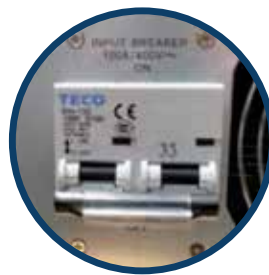
Breaker de entrada
