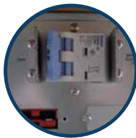
Breaker de baterías
